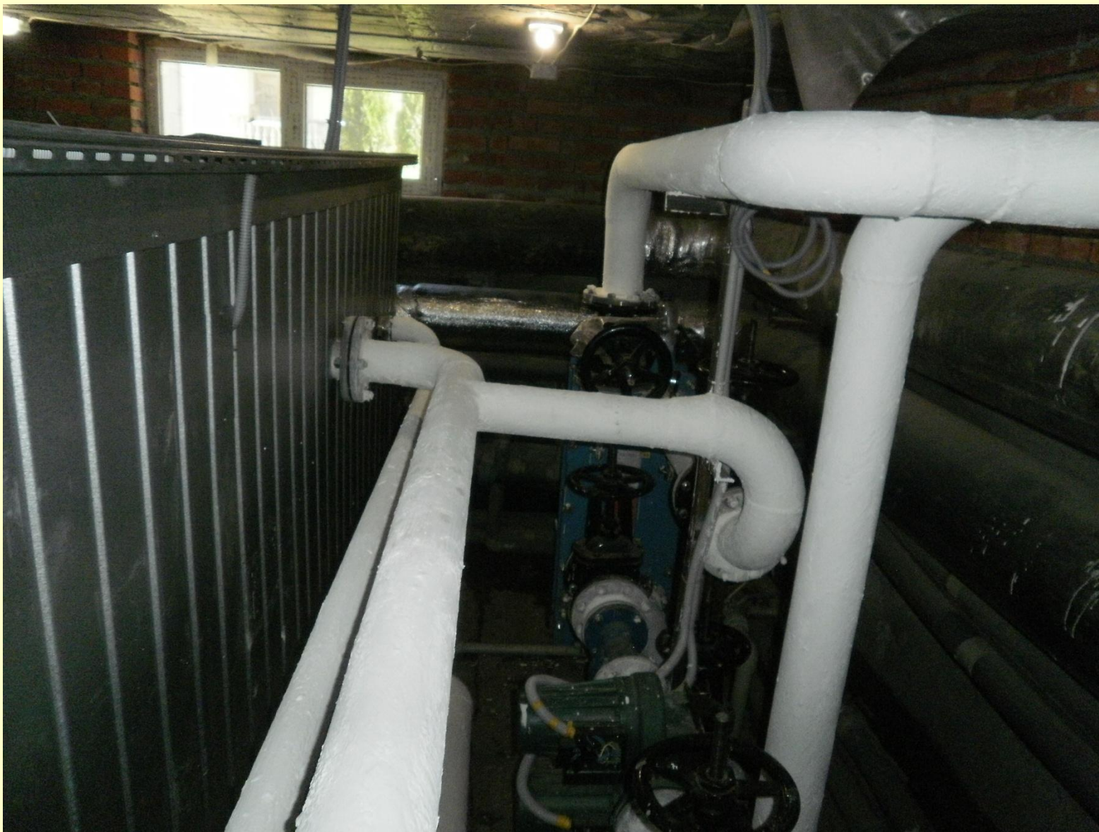
Акумулятор 52 м3. з насосами і теплообмінником
