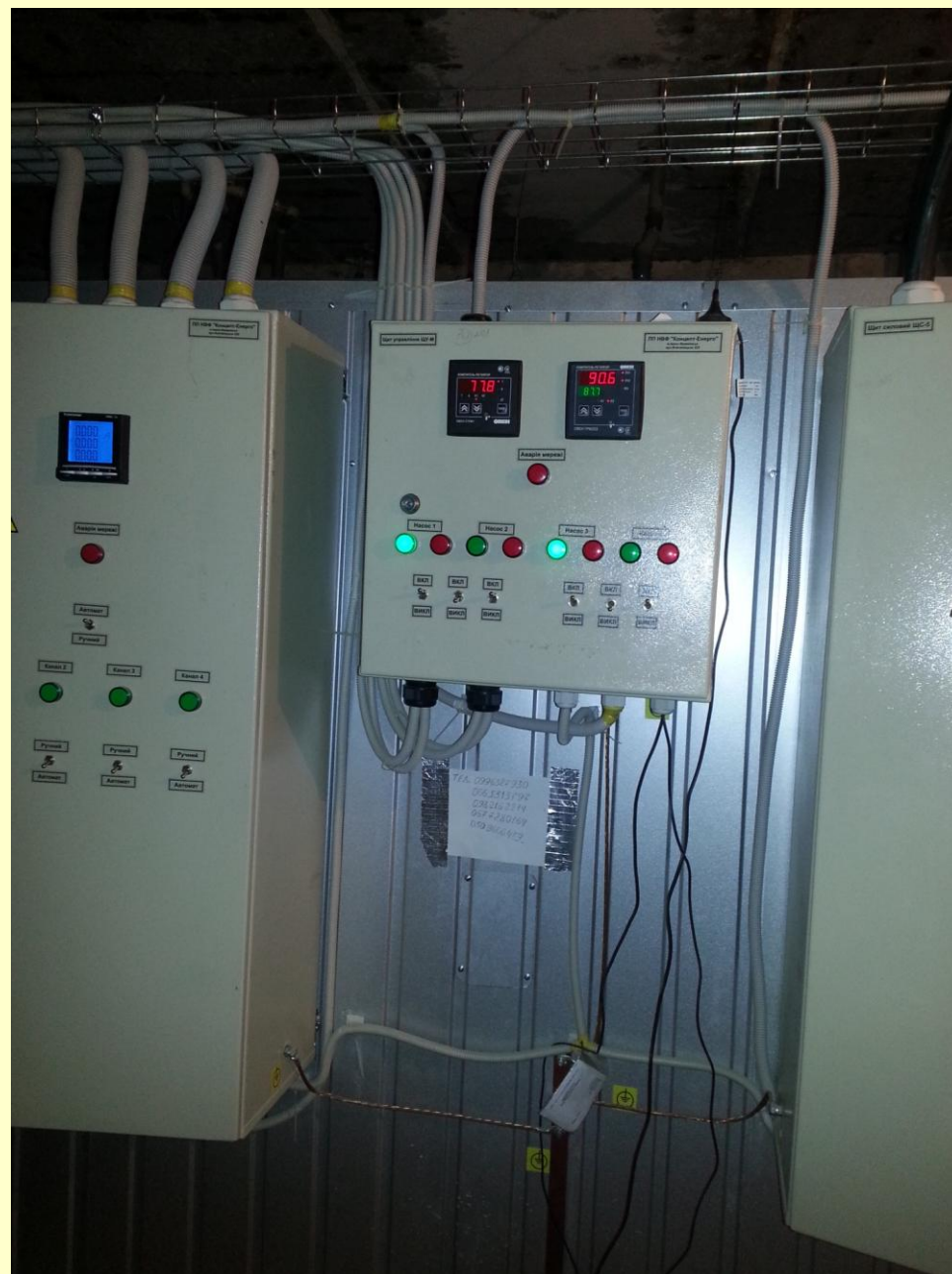
АВТОМАТИКА УПРАВЛІННЯ. Макс. потужн.405 кВт.
