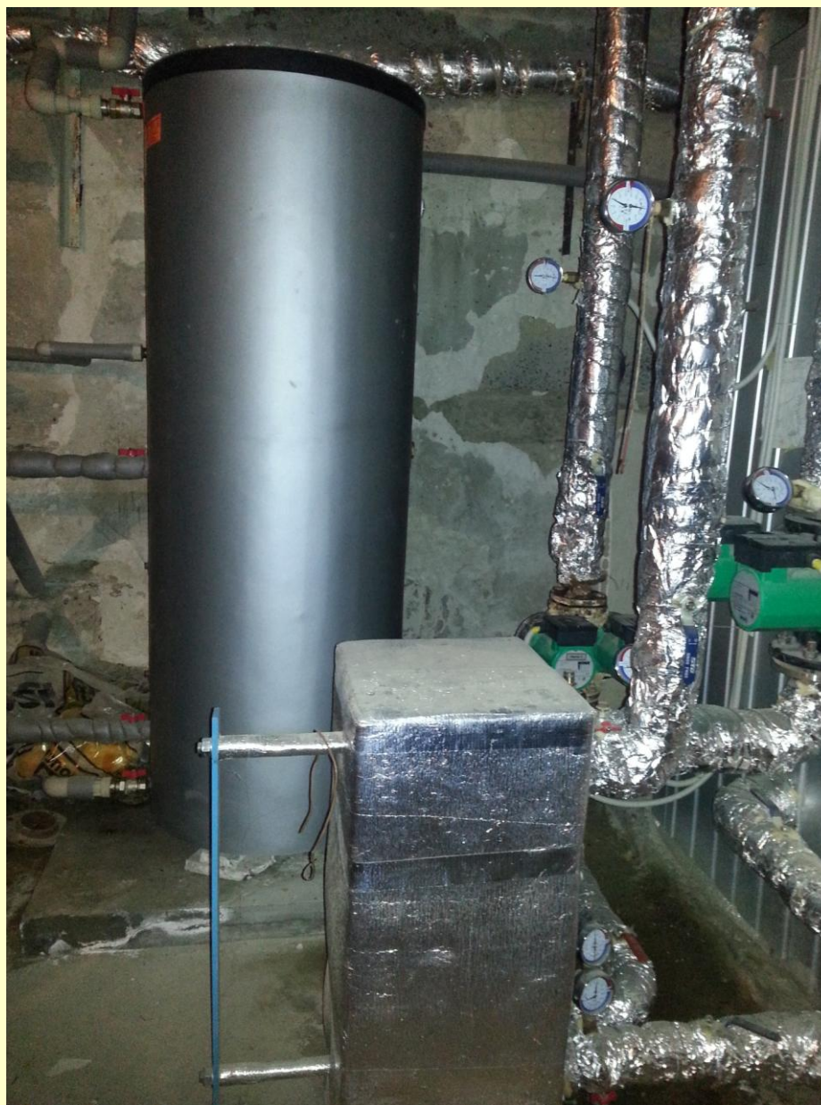
Бойлер в системі для гарячого водопостачання
