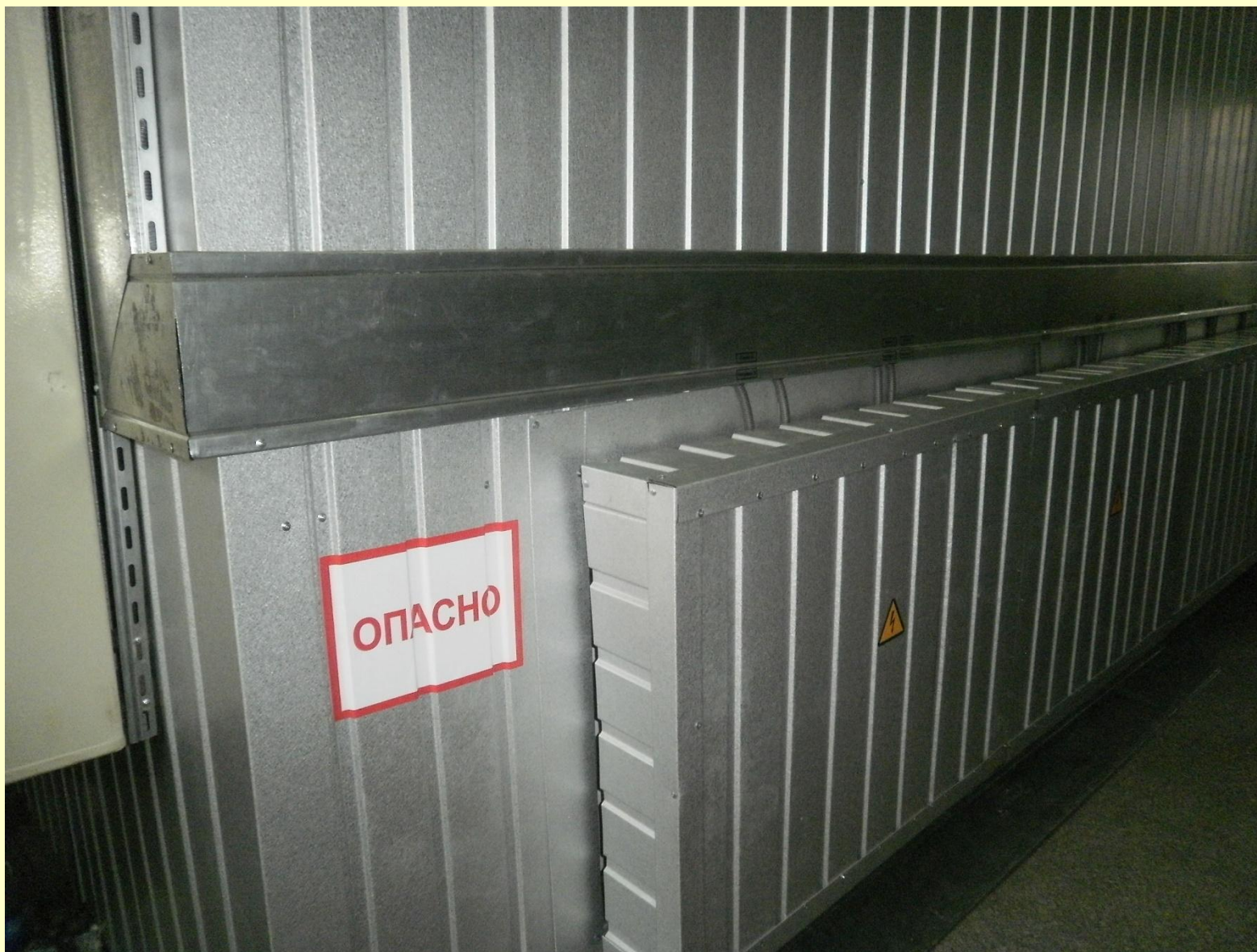
Теплоаккумулятор об'ємом 24 мЗ
