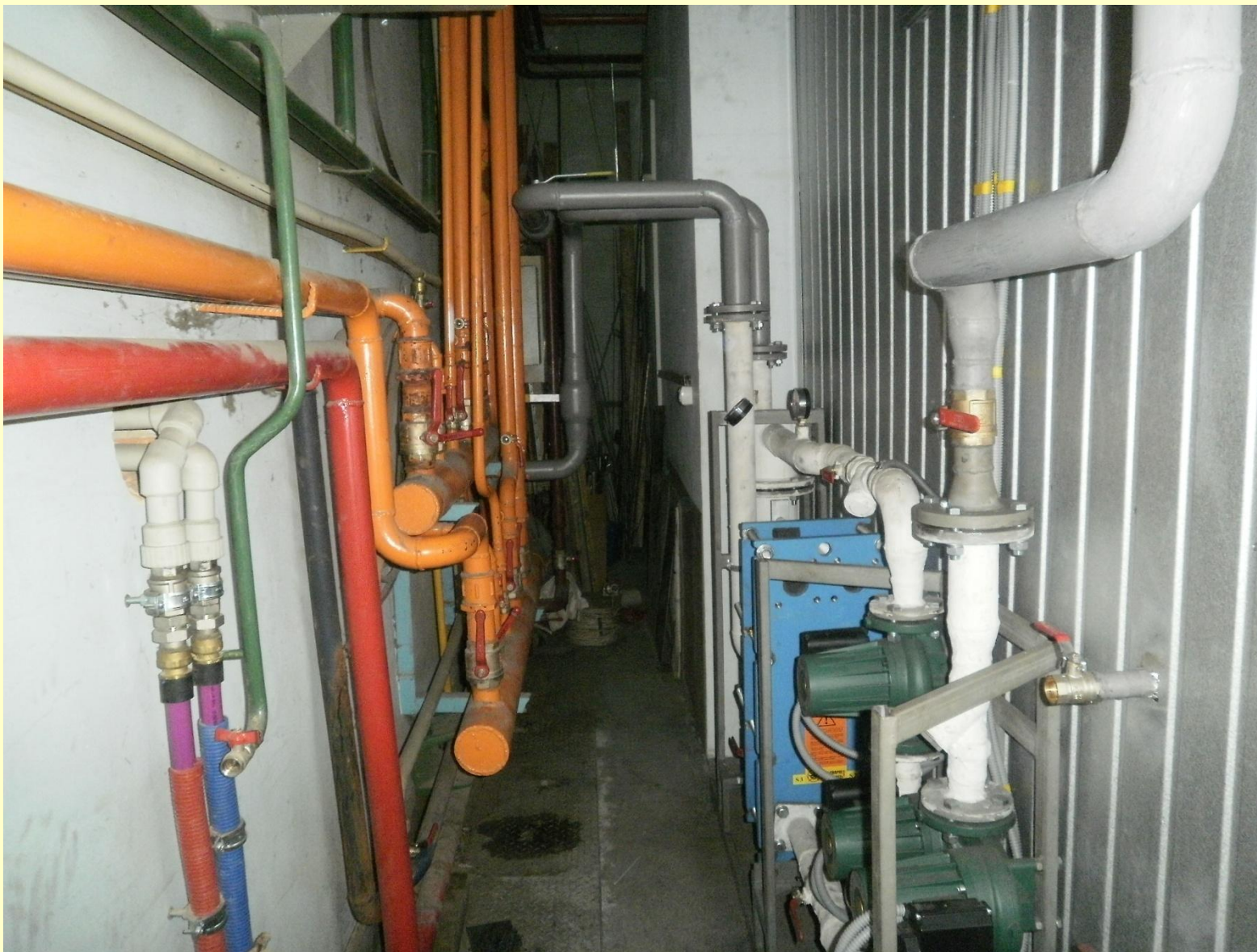
Система в зборі. Насосна станція
