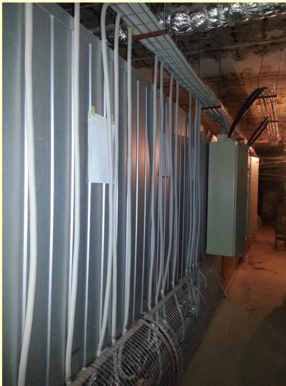
Акумулятор тепла, об'єм 60м3.
