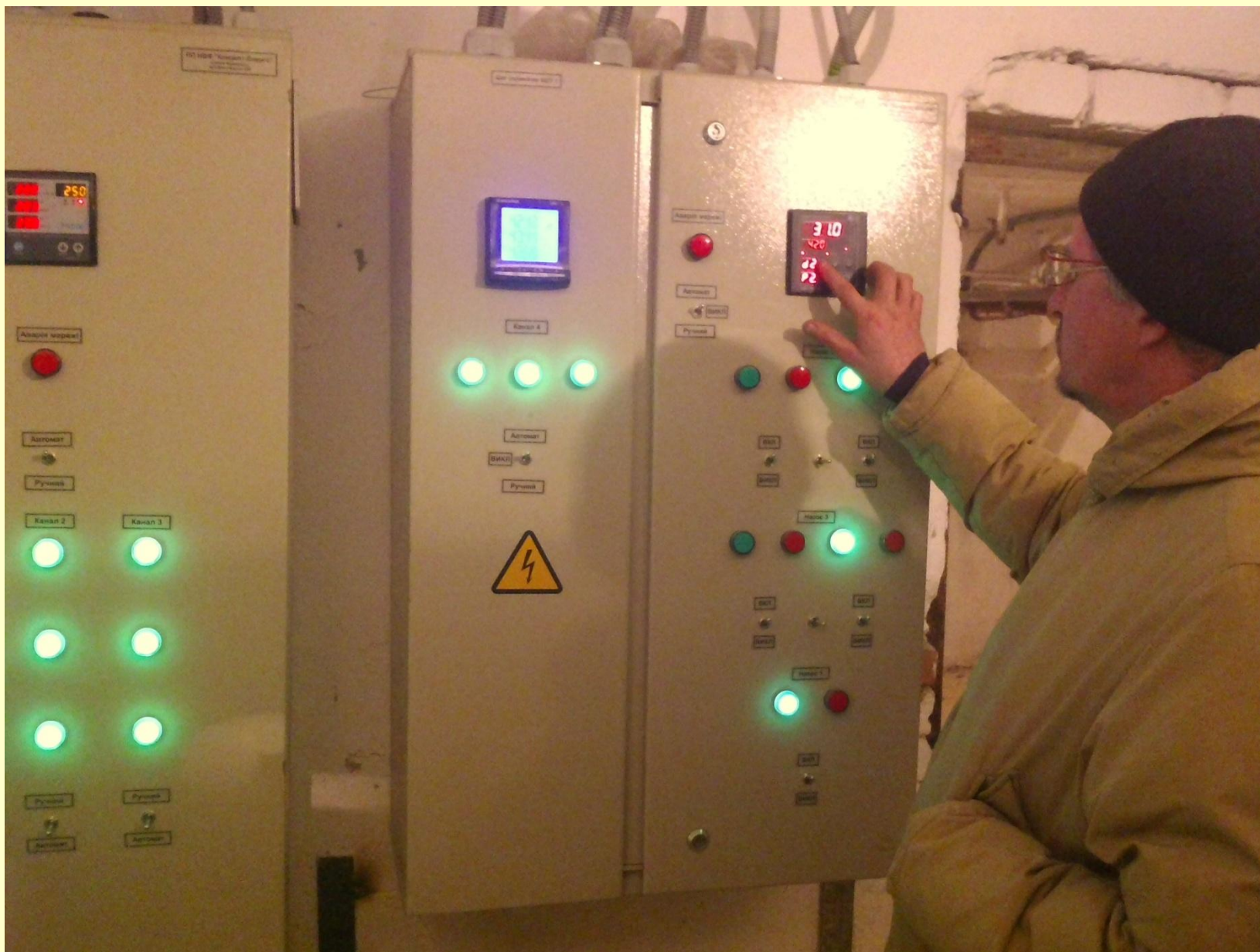
Налаштування автоматики. Електрична потужність 180 кВт
