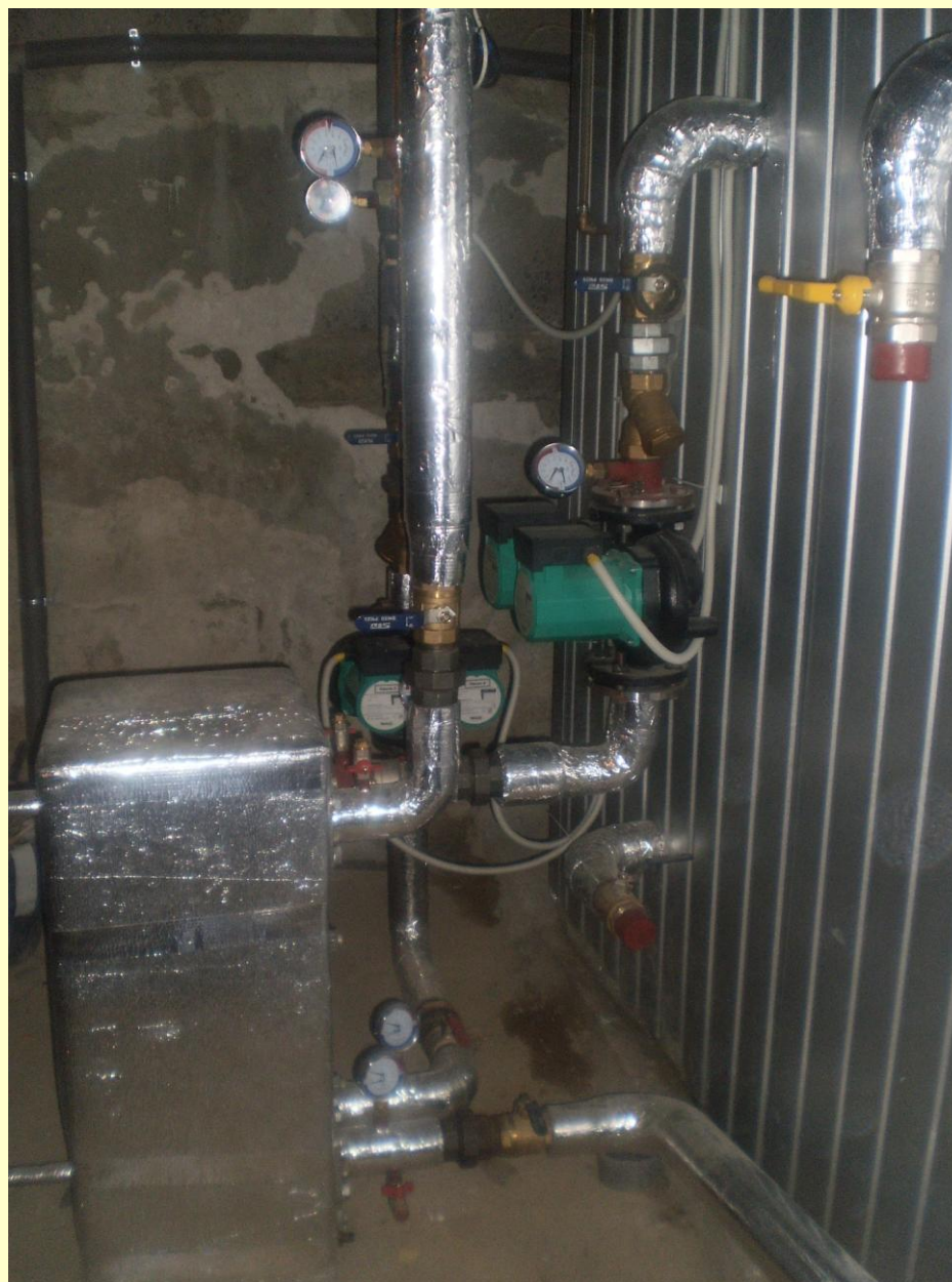
Насосні групи з теплообмінником
