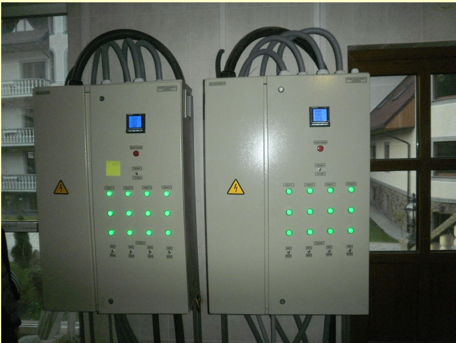
Щити силові 360 кВт системи «Дністер» в роботі
