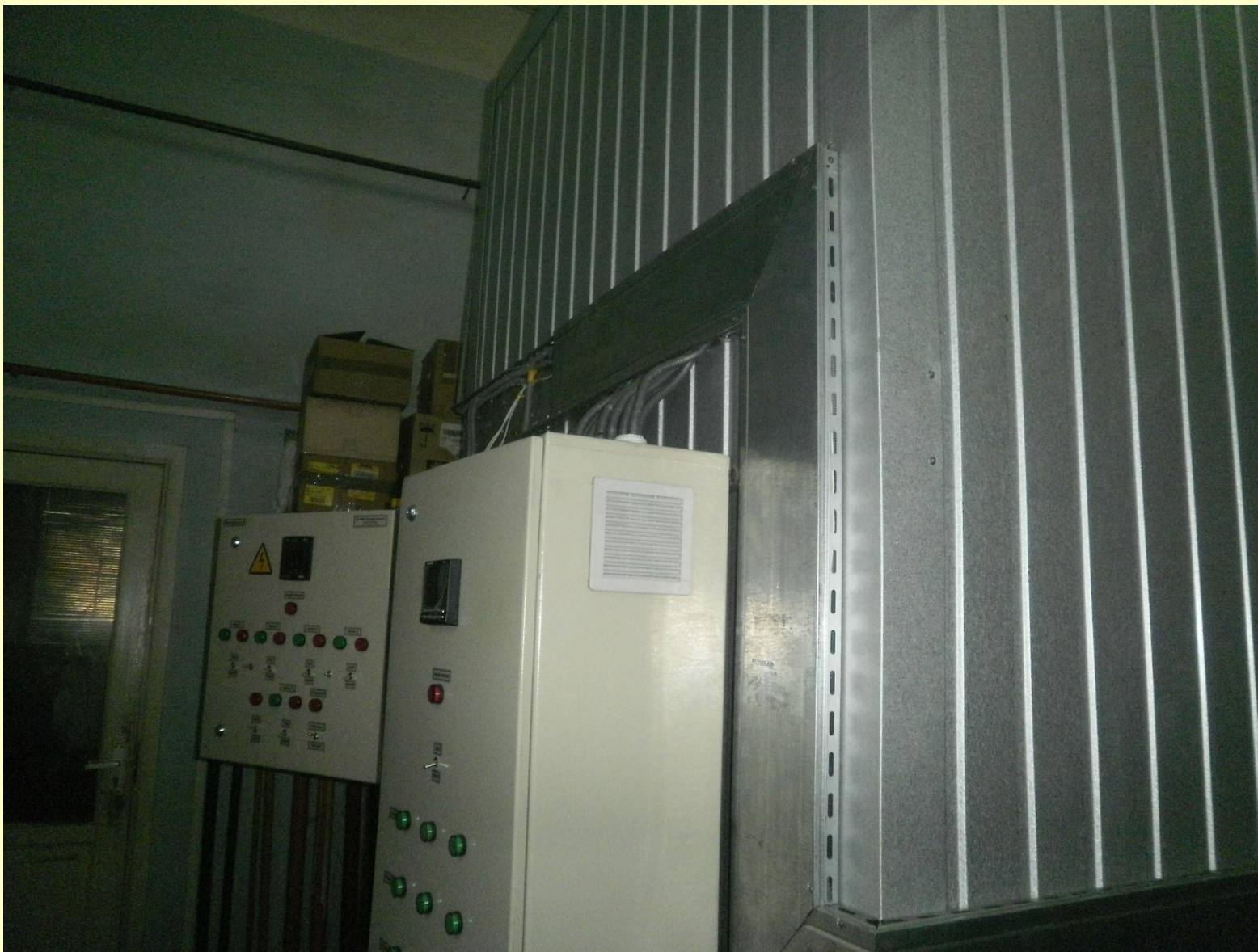
Система в зборі. Електричні щити 180 кВт
